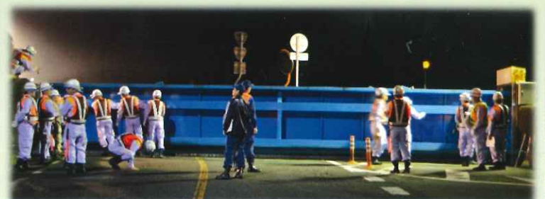
陸閘をすべて引き出して堤防を塞ぎます。
