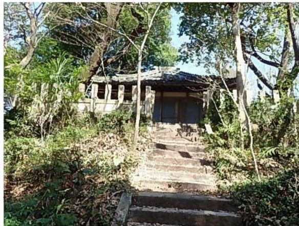
写真 劣化が進む太子堂
