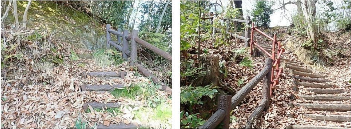
写真 劣化した遊歩道(左：劣化した階段工 右：仮修繕のままの柵工)
